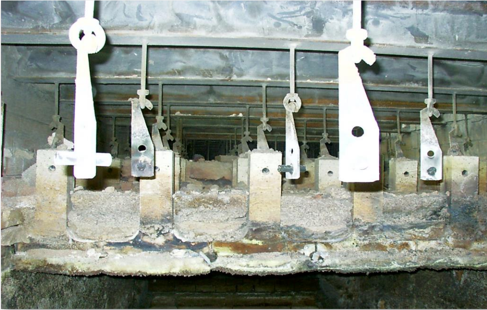
Infiltrierte Ofendecke im Bereich der Aufheizzone nach einer Laufzeit von ca. 6-7 Jahren
