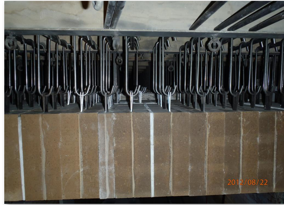
Abbildung der Hängedecke in den Hauptbrennzonen Deckentyp: Siemens-Martin-Hängedecke (ohne Hinterisolierung)
